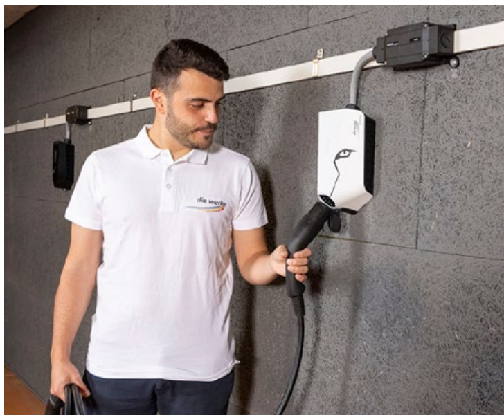
Ein Mitarbeiter von die werke an einer der Ladestationen; die Ladestationen in der Optik eines «Fuchsgesichts».
